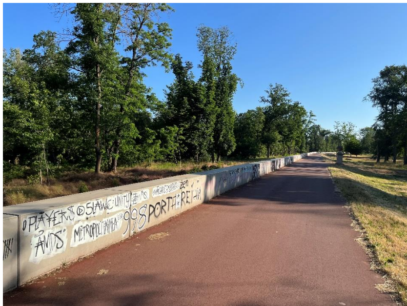
Anlage: Hochwasserschutzanlage im Herrenkrug (Foto: Manuel Rupsch)
